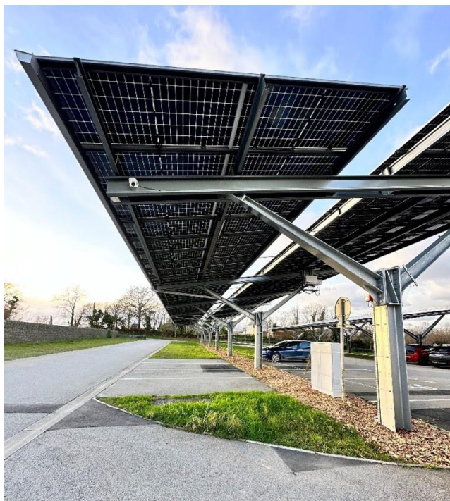
Ombrières avec ouverture au centre, végétalisation intégrée dans les noues drainantes
